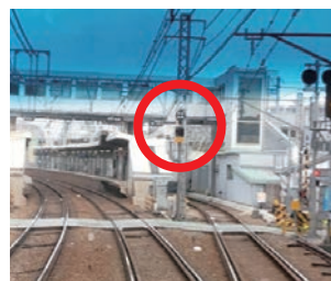
▲神奈川新町第1踏切道(下り線)に対する発光信号機の増設
