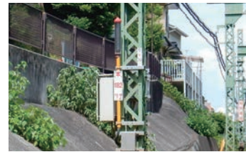
▲落石検知装置
