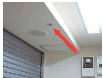
▲地下駅の火災対策「スプリンクラー」
